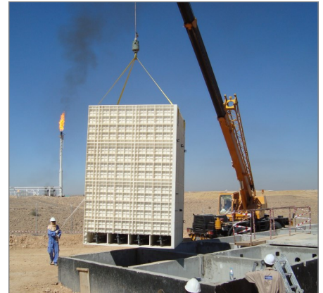
Instalación de Bioreactor en Yemen
